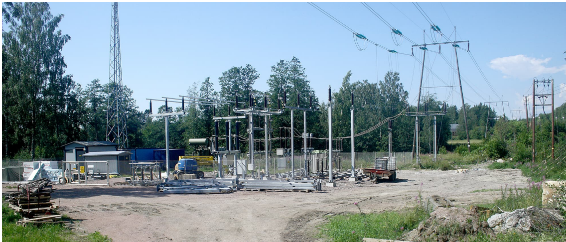
Alueella sijaitseva muuntamoalue, jonka ympäristö kaipaa jäsenystä.
